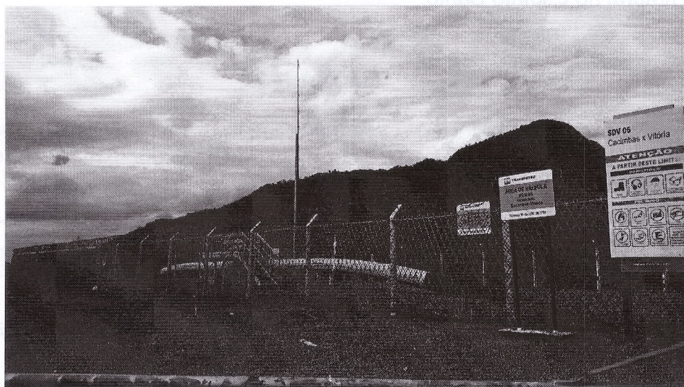
Figura 1 Área de Válvula aérea isolada em SDV 5 - BR101 - Muribeca.
