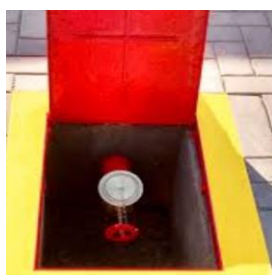
Hidrante de Recalque
