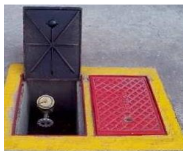
Hidrante de Recalque
