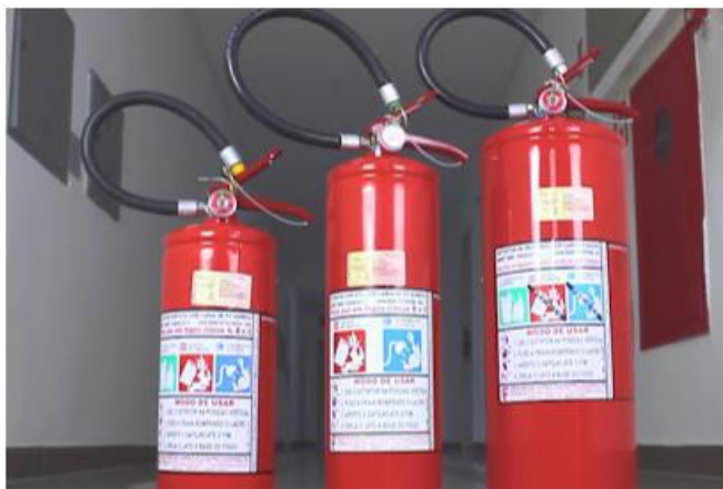
Extintores de incêndio
