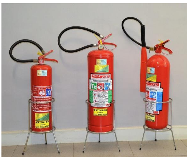
Extintores de incêndio
