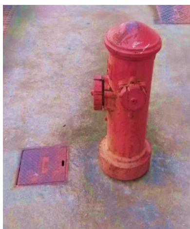
Hidrante de Coluna Urbano
